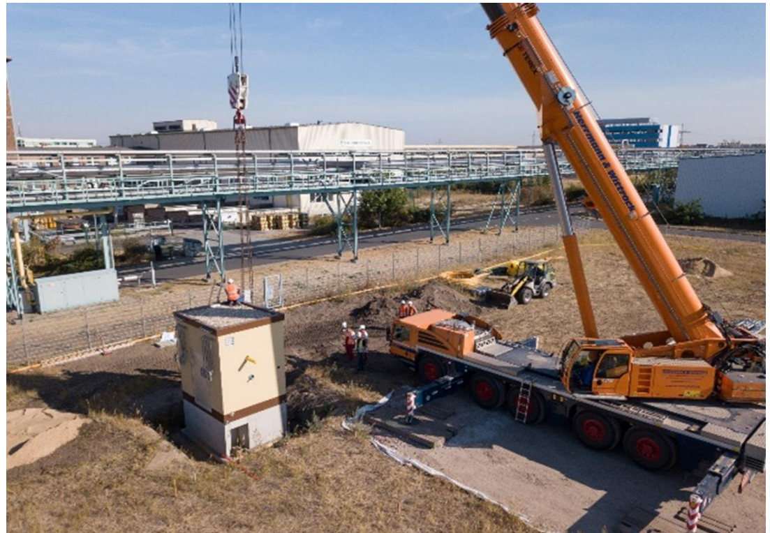
Aufstellung der GDRMA (Quelle: Mitnetz Gas)
